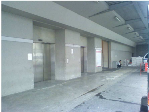
Loading area จุดรับ-ส่งสินค้า 2 cargo lifts S10-S11 ลิฟท์รับ-ส่งสินค้า 2 ตัว S10 และ S11
